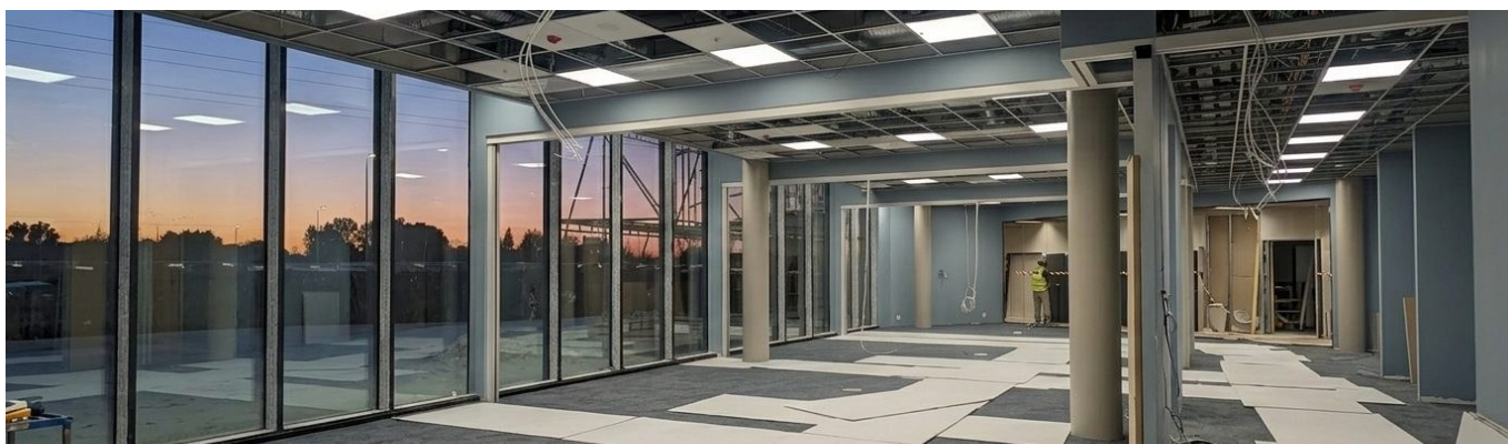
Obiekt przed odbiorem: oprawy zamontowane, sufit jeszcze otwarty, wykładzina już ułożona. To jest moment, w którym magistrala powinna zostać sprawdzona — a zwykle nie ma czym.
