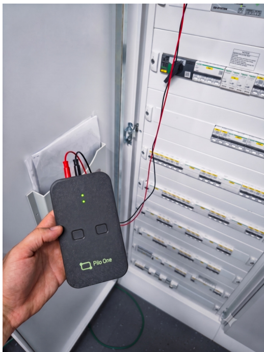
Przewody pomiarowe wpięte w magistralę przy otwartej rozdzielni.
