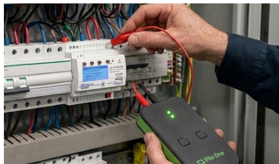
Wpięcie w rozdzielnicę, obok sterownika i zasilacza magistrali – na tych samych dwóch żyłach, na których pracuje system.
